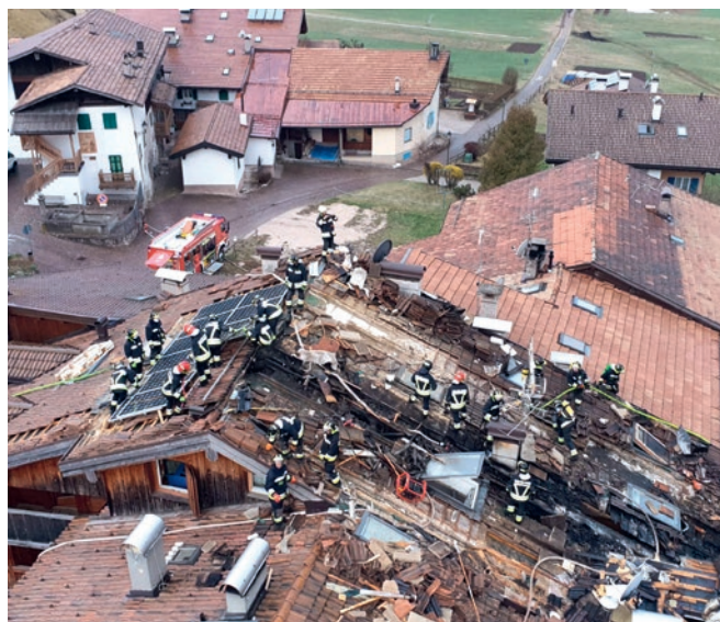
La copertura danneggiata a Zanolin
