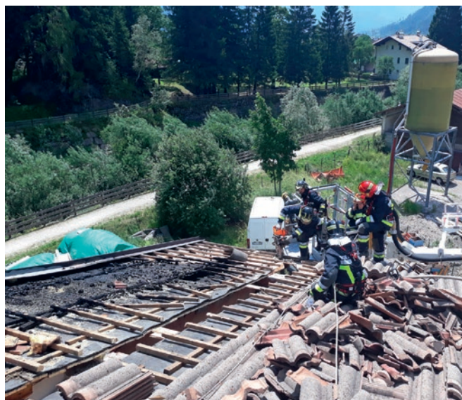
Incendio in via Marconi a Predazzo
