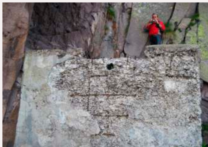
Un serbatoio d'acqua degli alpini sul Cardinal (1917)
